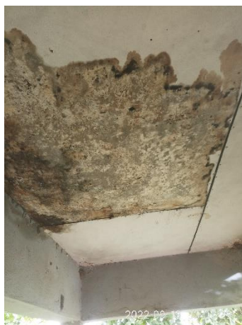
DÉGRADATION DU FAUX-PLAFOND SOUS L'EFFET DE L'HUMIDITÉ
