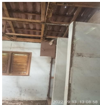
COUVERTURE EN TUILE DU POSTE DE GOUANÉ À REPRENDRE
