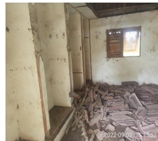
APERÇU DES DÉGRADATIONS DU BATIMENT À TOULO
