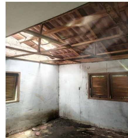
INTÉRIEUR DÉGRADÉ DU BATIMENT AU POSTE DE GOUANÉ
