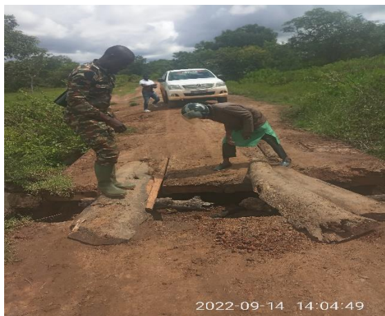
OUVRAGE DE FRANCHISSEMENT DE FORTUNE ENDOMMAGÉ
