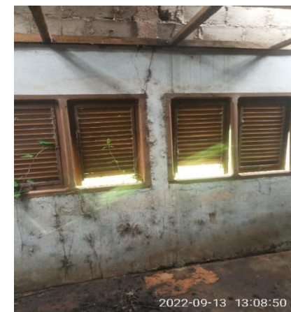
FENÊTRES-DALLAGE ET FAUX-PLAFOND À REMPLACER
