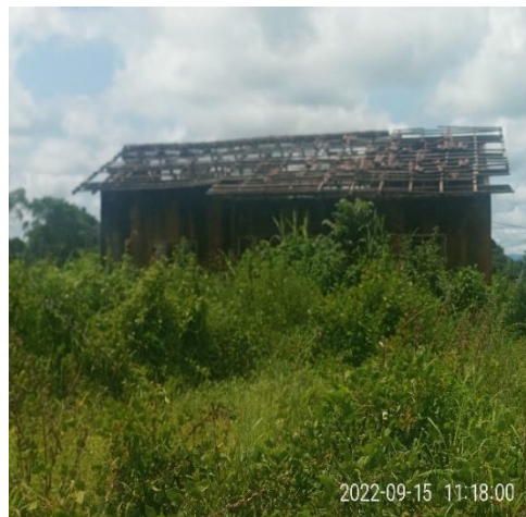
APERÇU DU POSTE DE GBÉTÉMA AU MILIEU DES BROUSSAILLES
